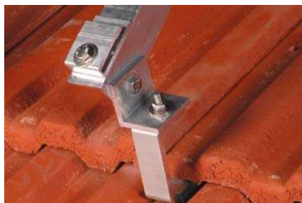
Befestigungsdreieck mit Dachbügel verschrauben Reihenfolge: Schraube - Befestigungswinkel - Aufлагewinkel - Scheibe - Mutter
